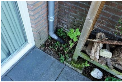
Regenpijp aan drainagebuis
