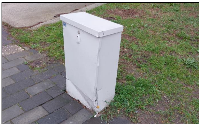
Figuur 14: Electriciteitskastje bij entree parkeergarage Annenborch
